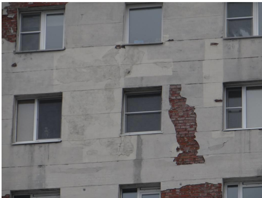
Рис. 3.1.2. Фрагмент фасада по оси «А» на участке в осях «2» - «3» в уровне 12 этажа. Следы увлажнения поверхностей фасада, приуроченные к подоконным отливам. Сети разнонаправленных трещин в штукатурном покрытии. Участки обрушения штукатурного покрытия.
