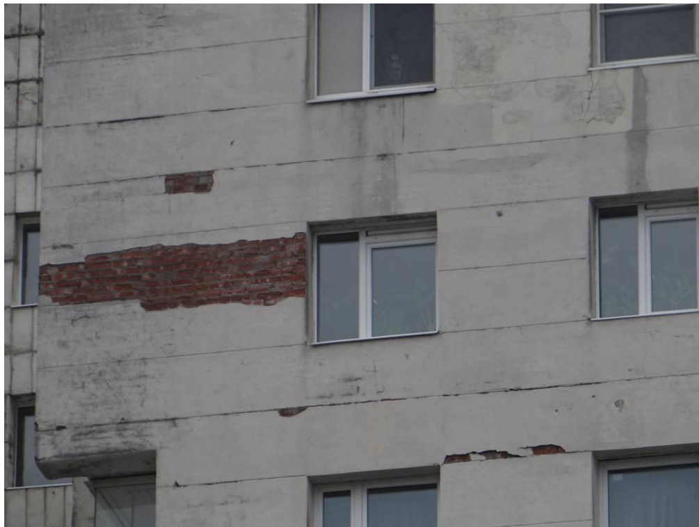
Рис. 3.1.1. Фрагмент фасада по оси «А» на участке в осях «2» - «3» в уровне 11 этажа. Следы увлажнения поверхностей фасада. Сети разнонаправленных трещин в штукатурном покрытии. Участки обрушения штукатурного покрытия. Морозное разрушение материалов кирпичной кладки.
