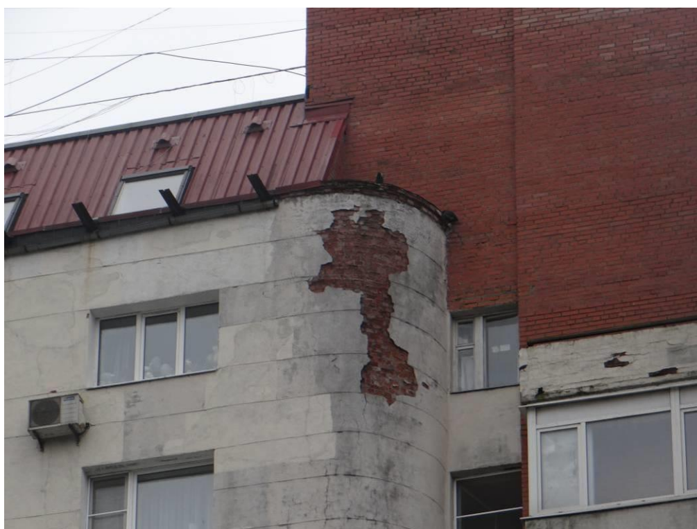
Рис. 3.1.8. Фрагмент фасада по оси «Б» на участке в осях «9» - «10» в уровне 13 этажа. Следы увлажнения поверхностей фасада, приуроченные к кровельному свесу. Сети разнонаправленных трещин в штукатурном покрытии. Участки обрушения штукатурного покрытия. Морозное разрушение материалов кирпичной кладки.
