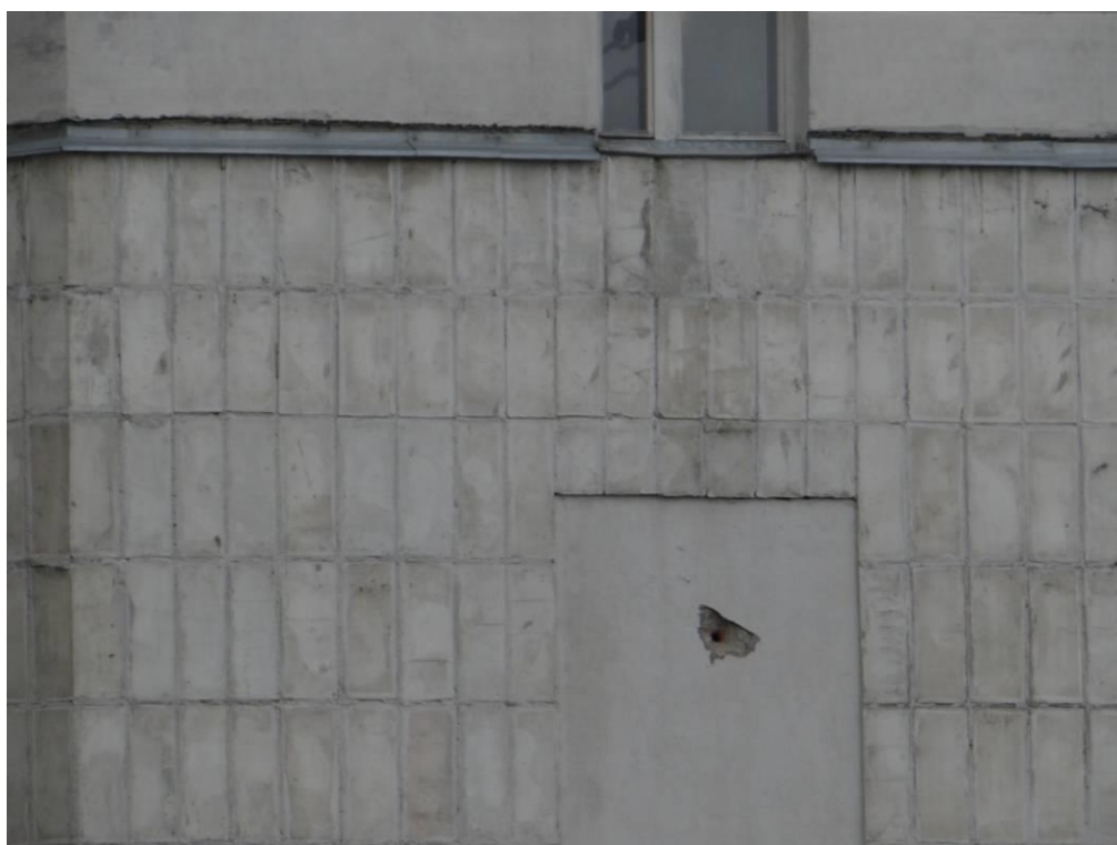
Рис. 3.2.2. Фрагмент фасада по оси «А» на участке в осях «3» - «4» в уровне 2 этажа. Следы увлажнения облицовки, высолы в швах между плитами. Многочисленные разнонаправленные трещины в облицовочных плитах.
