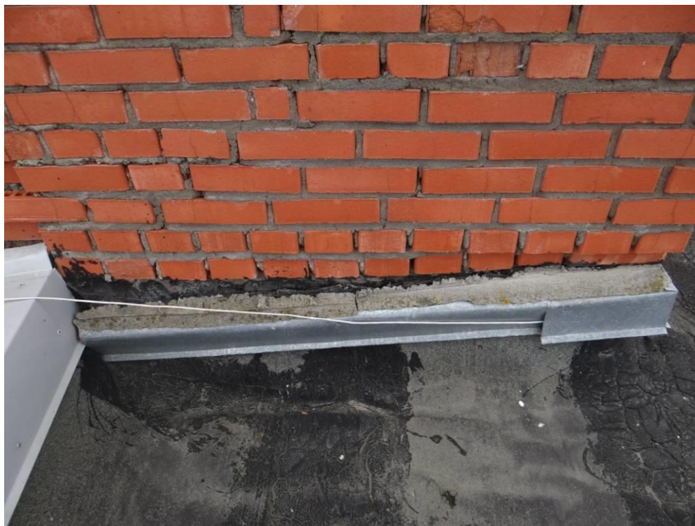
Рис. 3.5.3. Блок-секция №1. Нарушение технологии устройства узла примыкания кровельного ковра к поверхности стены. Отсутствует прижимная планка, отлив установлен без устройства выдры.
