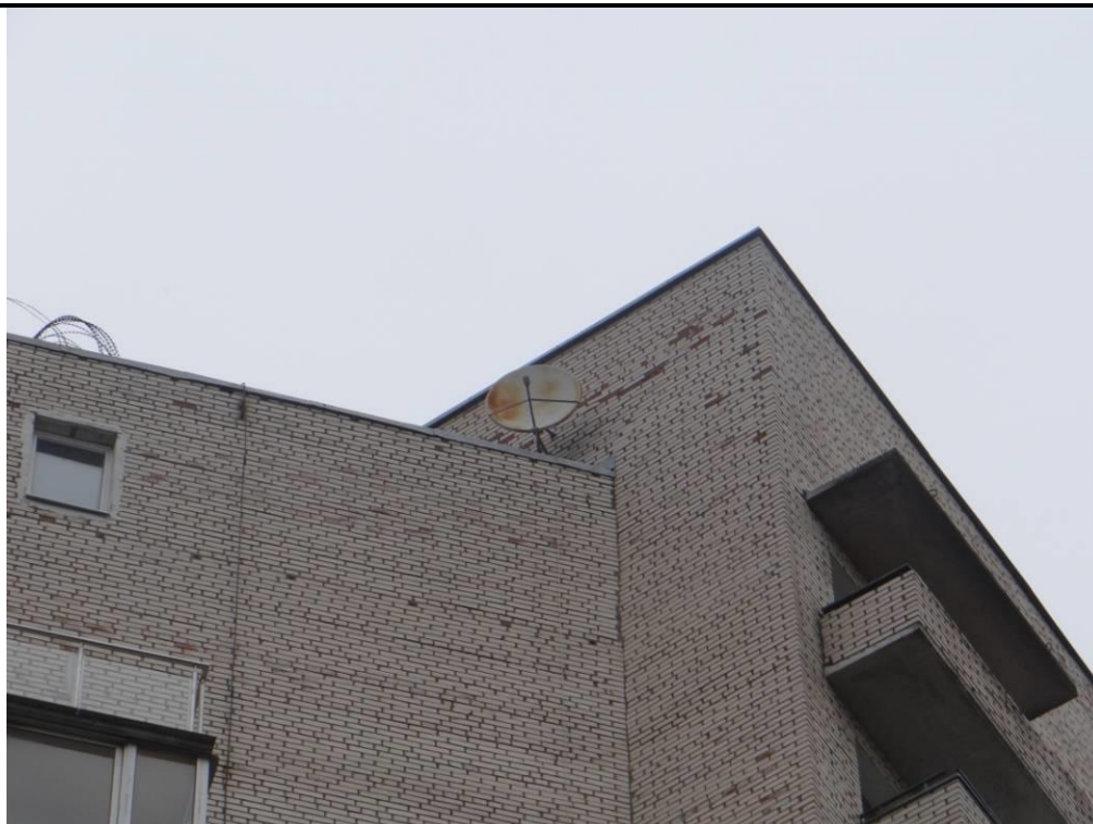
Рис. 3.3.3. Фрагмент фасада по оси «б» на участке в осях «Г» - «Е» в уровне 16 этажа. Следы увлажнения кирпичной кладки в уровне технического этажа. Морозное разрушение материалов кладки на увлажненных участках. Износ и отслоение глазурованного слоя кирпичей.
