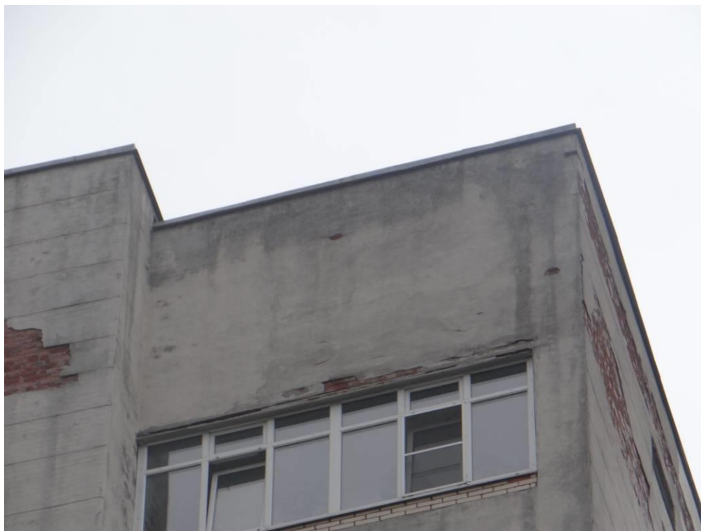
Рис. 3.1.13. Фрагмент фасада по оси «2» на участке в осях «В» - «А» в уровне 16 этажа. Отслоение штукатурного покрытия от кирпичного основания на значительном по площади участке. Коррозия металлических элементов перемычек над оконными проемами.
