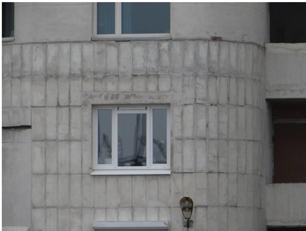
Рис. 3.2.1. Фрагмент фасада по оси «А» на участке в осях «3» - «4» в уровне 2 этажа. Следы увлажнения облицовки, высолы в швах между плитами. Многочисленные разнонаправленные трещины в облицовочных плитах. Отсутствие отлива между плоскостью стены и облицовкой бетонными плитками.
