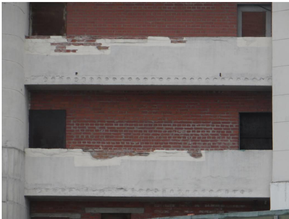
Рис. 3.4.1. Общий вид балконов вдоль стены по оси «В» на участке в осях «4» - «5». Следы увлажнения кирпичной кладки ограждения балконов. Деструкция штукатурного покрытия и морозное разрушение материалов кирпичной кладки.
