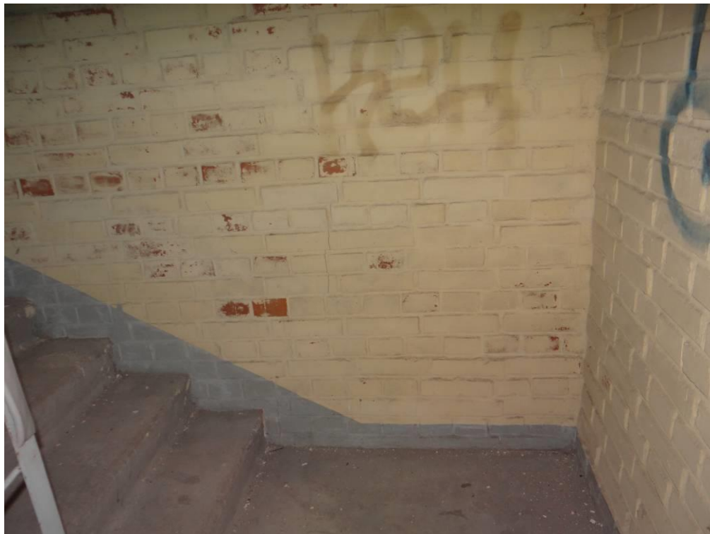
Рис. 3.6.2. Блок-секция №2. Протяженная трещина в кирпичной кладке стены по оси «10» на участке примыкания стены по оси «Е».
