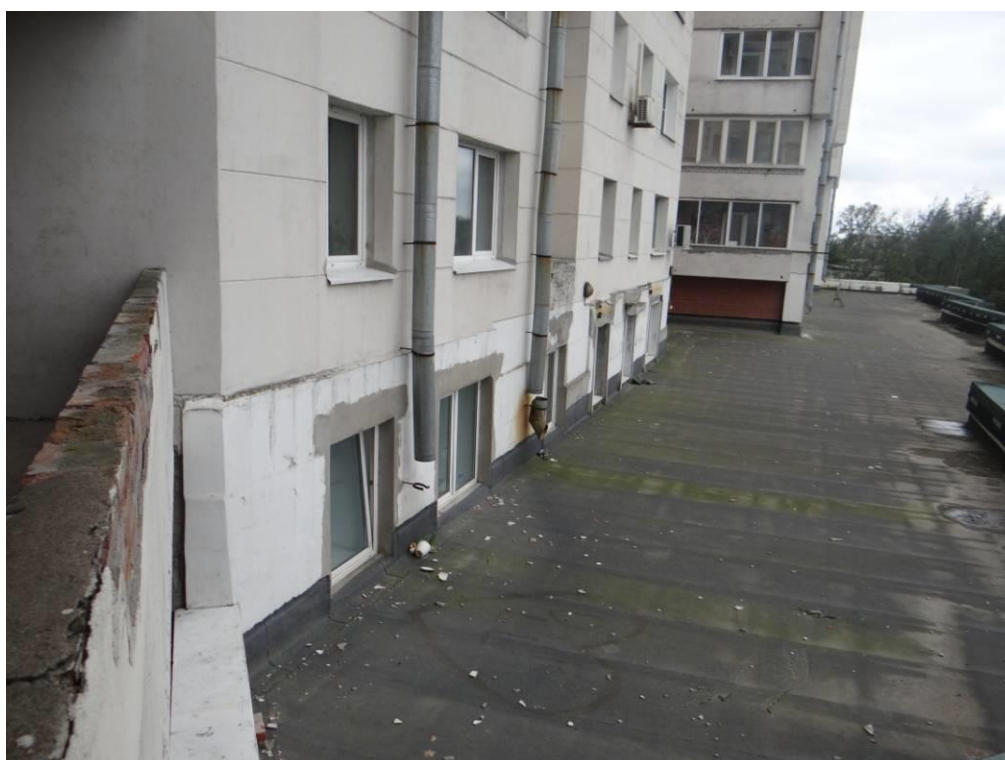
Рис. 3.2.4. Фрагмент фасада по оси «Б» на участке в осях «5» - «10» в уровне 2 этажа. Следы увлажнения облицовки. Многочисленные разнонаправленные трещины в облицовочных плитах. Отсутствие отлива между плоскостью стены и облицовкой бетонными плитками.
