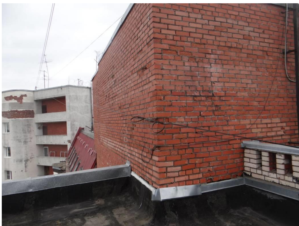
Рис. 3.5.4. Блок-секция №2. Нарушение технологии устройства узла примыкания кровельного ковра к поверхности стены. Отсутствует прижимная планка, отлив установлен без устройства выдры.
