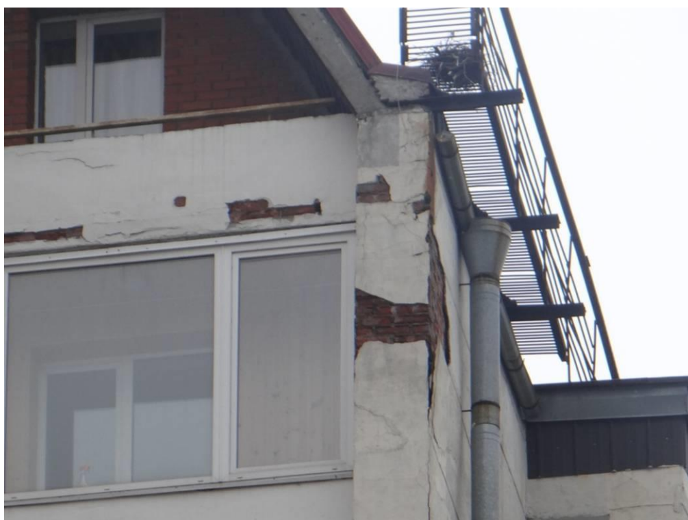
Рис. 3.1.14. Фрагмент фасада по оси «17» на участке в осях «А» - «В» в уровне 13 этажа. Отслоение штукатурного покрытия от кирпичного основания на значительном по площади участке.
