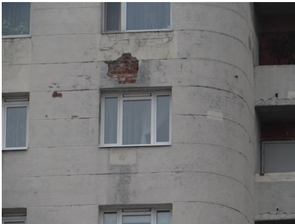
Рис. 3.1.5. Фрагмент фасада по оси «А» на участке в осях «3» - «4» в уровне 10 этажа. Следы увлажнения поверхностей фасада, приуроченные к подоконным отливам. Сети разнонаправленных трещин в штукатурном покрытии. Участки обрушения штукатурного покрытия. Морозное разрушение материалов кирпичной кладки.
