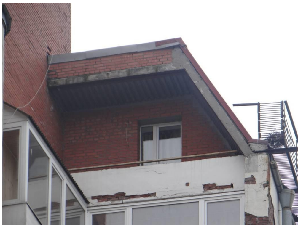
Рис. 3.4.2. Общий вид балконов вдоль стены по оси «12» на участке в осях «Б» - «В». Следы увлажнения кирпичной кладки ограждения балконов. Деструкция штукатурного покрытия и морозное разрушение материалов кирпичной кладки.
