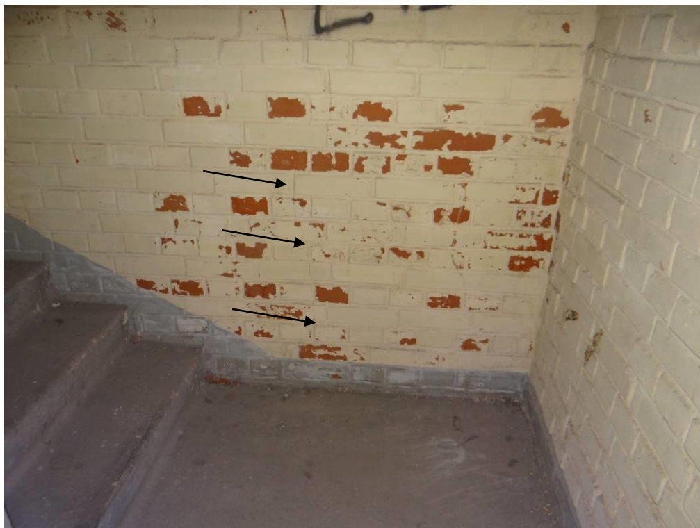
Рис. 3.6.1. Блок-секция №1. Протяженная трещина в кирпичной кладке стены по оси «16» на участке примыкания стены по оси «Д».
