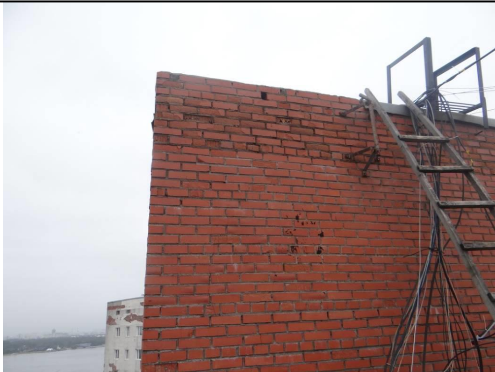
Рис. 3.3.5. Фрагмент фасада по оси «16» на участке в осях «А» - «Д» в уровне технического этажа. Утрата окрытия. Следы увлажнения кирпичной кладки в уровне технического этажа. Морозное разрушение материалов кладки на увлажненных участках.
