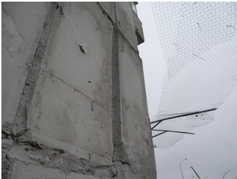
Рис. 3.2.3. Фрагмент фасада по оси «1» на участке в осях «Г» - «В» в уровне 1 этажа. Низкое качество работ по монтажу плиток. Не соблюдена плоскость, швы между плитами заполнены некачественно.
