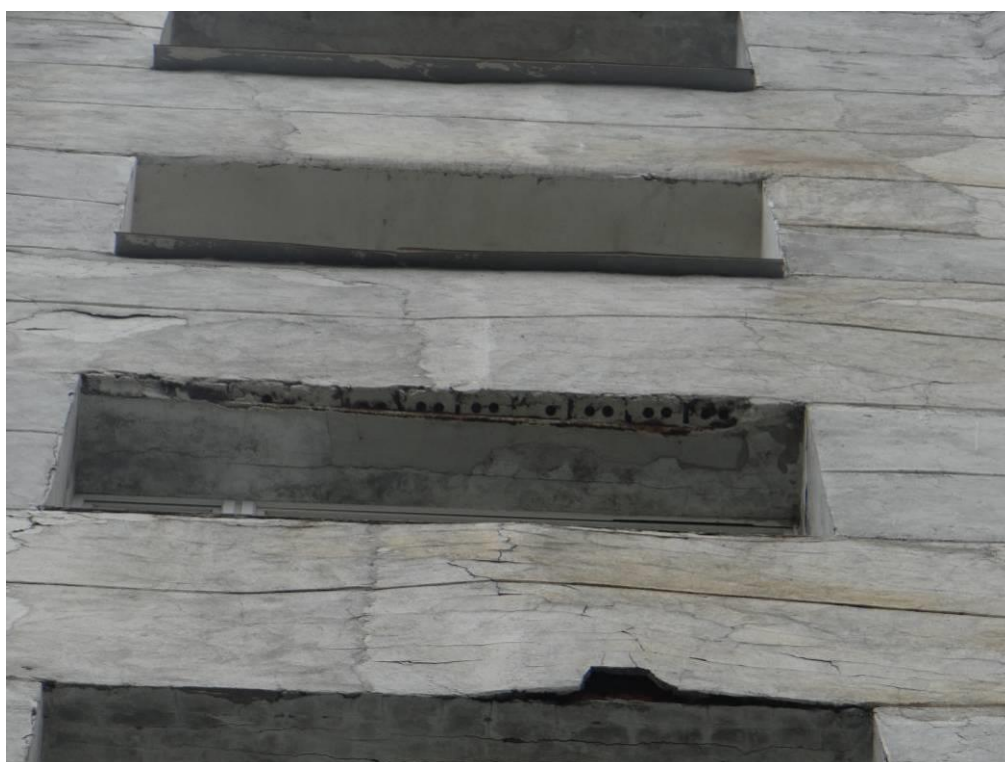
Рис. 3.1.12. Фрагмент фасада по оси «Б» на участке в осях «17» - «18» в уровне 6-7 этажей. Отслоение штукатурного покрытия от кирпичного основания на значительном по площади участке. Свес подоконного отлива отсутствует. Коррозия металлических элементов перемычек над оконными проемами.
