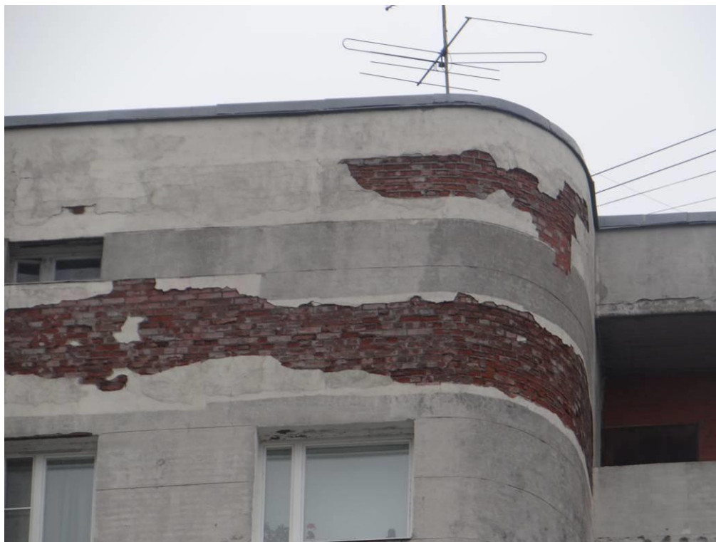
Рис. 3.1.3. Фрагмент фасада по оси «А» на участке в осях «3» - «4» в уровне 16 этажа. Следы увлажнения поверхностей фасада, приуроченные к подоконным отливам. Сети разнонаправленных трещин в штукатурном покрытии. Участки обрушения штукатурного покрытия. Морозное разрушение материалов кирпичной кладки.
