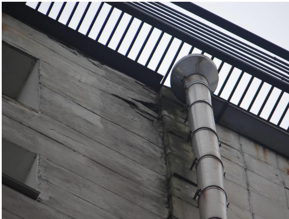
Рис. 3.1.11. Фрагмент фасада по оси «Б» на участке у оси «19» в уровне 13 этажа. Следы увлажнения поверхностей фасада, приуроченные к элементам системы водостока. Сети разнонаправленных трещин в штукатурном покрытии. Участки отслоения и обрушения штукатурного покрытия.
