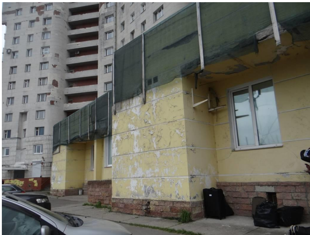
Рис. 3.1.17. Фрагмент фасада по оси «Б» на участке в осях «7» - «8» в уровне 1 этажа.
