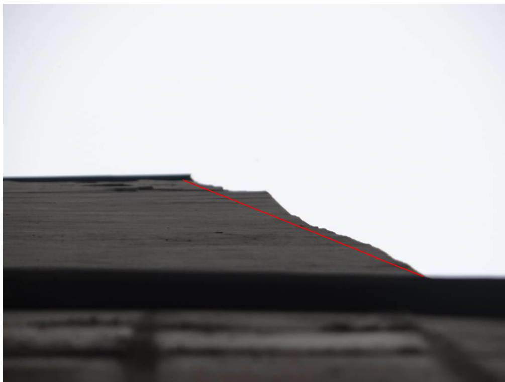
Рис. 3.1.19. Общий вид фасада по оси «1» (в плоскости рисунка) на угловом участке у оси «Г» (из плоскости рисунка). Отклонение отдельных участков фасада от вертикали, локальные неровности.
