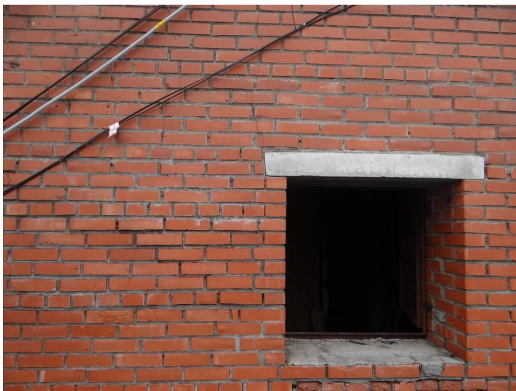
Рис. 3.3.6. Фрагмент фасада по оси «16» на участке в осях «А» - «Д» в уровне технического этажа. Протяженные вертикальные трещины в кирпичной кладке, приуроченные к торцам перемычки над дверным проемом.
