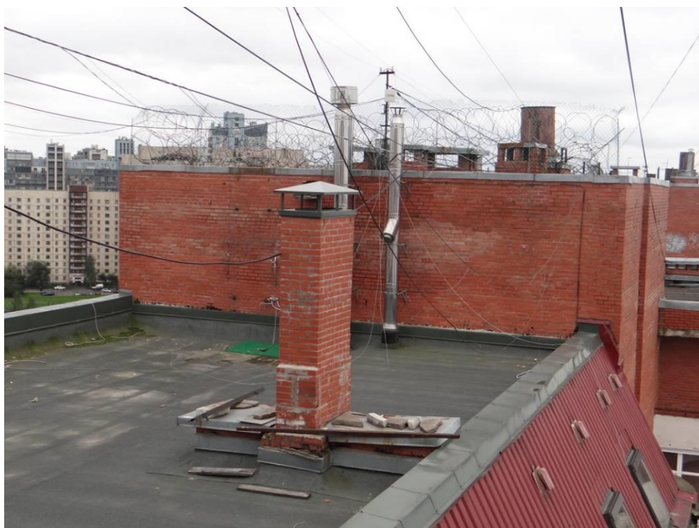
Рис. 3.5.2. Общий вид кровли первой блок-секции №2. Многочисленные следы застоя воды на поверхности кровли, поражение кровельного ковра самосевными растениями.
