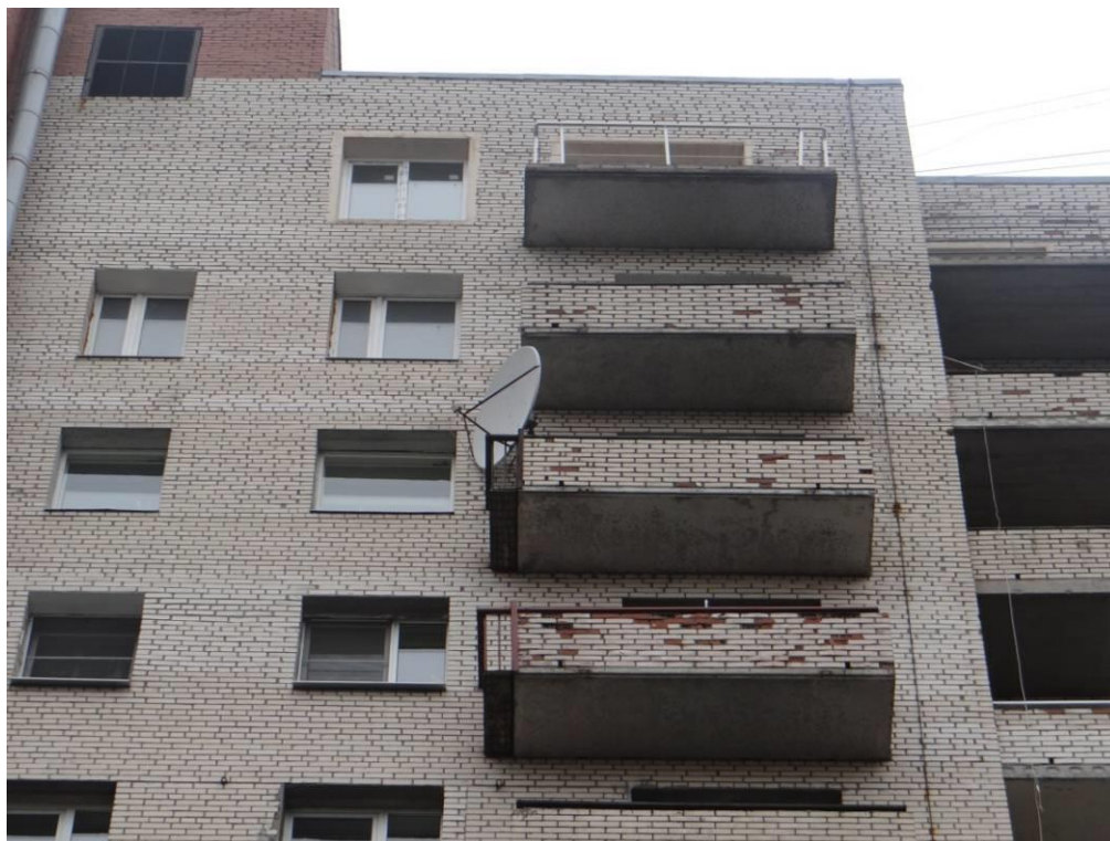
Рис. 3.4.3. Общий вид балконов вдоль стены по оси «Е» на участке в осях «15» - «14». Следы увлажнения кирпичной кладки ограждения балконов. Морозное разрушение материалов кирпичной кладки.
