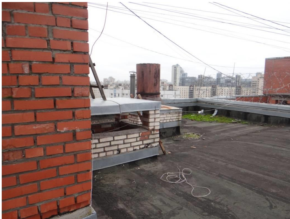
Рис. 3.5.1. Общий вид кровли первой блок-секции №1. Многочисленные следы застоя воды на поверхности кровли, поражение кровельного ковра самосевными растениями.
